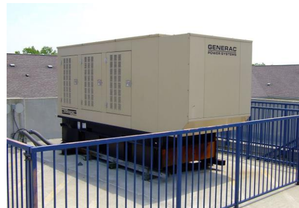
Backup generator. Source: Wikimedia Commons
